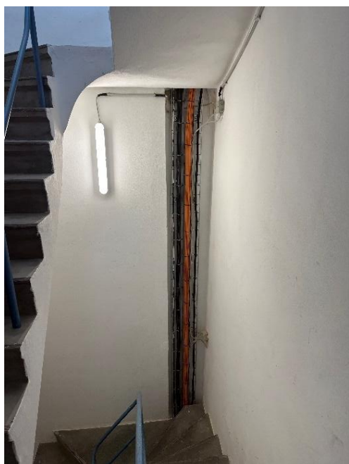
Abbildung 10: Leitungsanlagen im notw. Treppenraum Stand 14.02.2025
