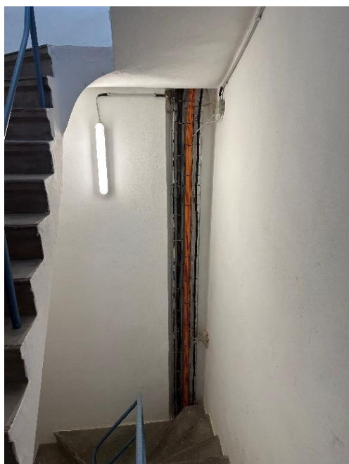
Abbildung 10: Leitungsanlagen im notw. Treppenraum Stand 14.02.2025
