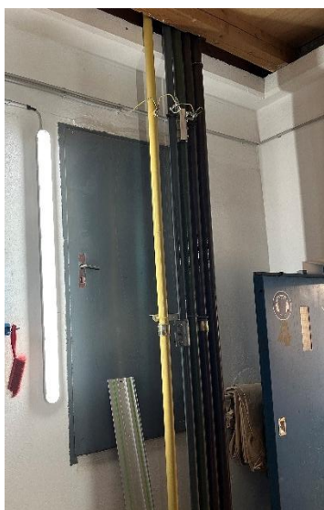
Abbildung 5: Ehemalige Tür im 4. OG zum Kleiesilo
