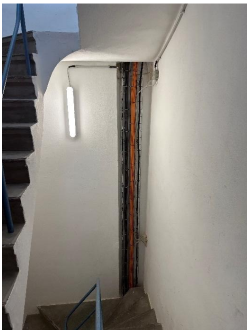
Abbildung 10: Leitungsanlagen im notw. Treppenraum Stand 14.02.2025
