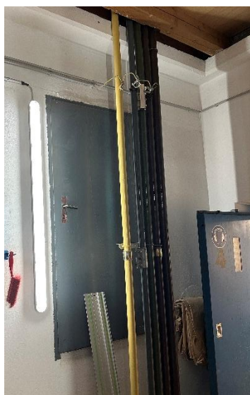
Abbildung 5: Ehemalige Tür im 4. OG zum Kleiesilo
